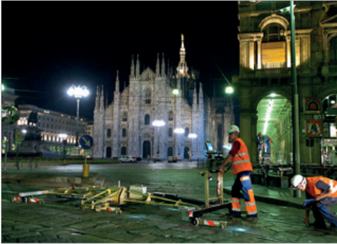
Die Gleisnetzdigitalisierung beinhaltet digitale Bestands- und Zustandsdatenerfassung aus Gleisgeometriemessung, Schienenquerprofilscan und visueller Prüfung.
